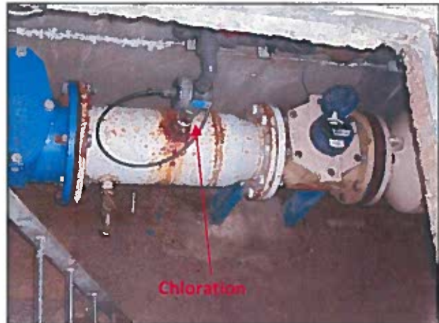
Photographie 4 : Compteur volumétrique, chloration et robinet de prélèvement
