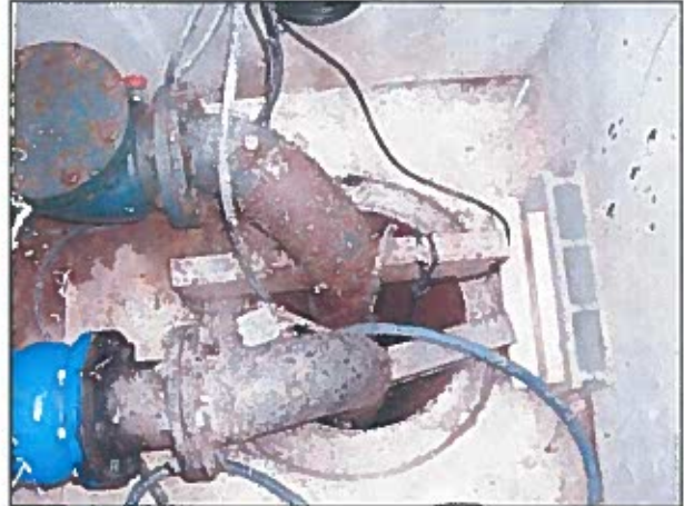
Photographie 2 : Colonne des pompes
