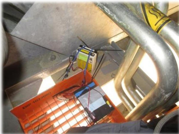
Photo 10 : Vue du dispositif installé côté gauche de la trappe arrière : Anabat SD1 micro à l'envers posé sur une planche de bois et branché sur batterie 12 V (G. Marchais - Ecosphère)
