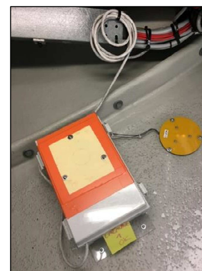
Figure 2 : Cliché de l'installation du Batcorder en nacelle avec micro à travers la paroi de la nacelle
