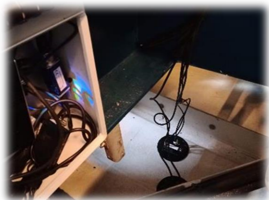
Batmode S+ installé dans la nacelle de l'éolienne E1 (Écosphère)
