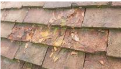
Dégradation des tuiles
