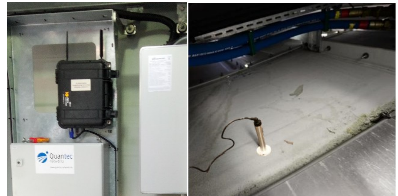
Figure 2 : Boîtier TrackBat placé en nacelle (à gauche), avec microphone déporté sur la face inférieure de la nacelle d'une éolienne (à droite).
