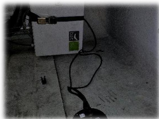
Batmode S+ installé en nacelle de l'éolienne E3 (H. Auclair)
