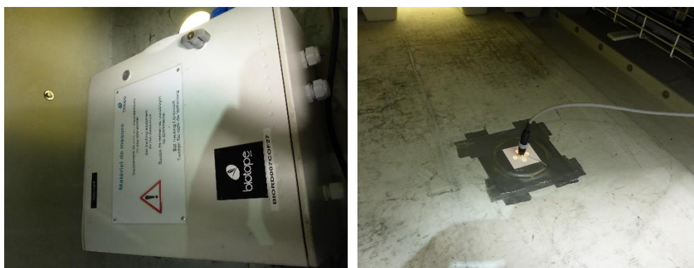
Figure 11 : Illustrations d'un coffret et microphone installé sur les éoliennes E02 et E06 du parc de Chassepain.
