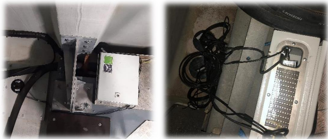
Batmodes S+ installés en nacelles des éoliennes LMD5 à gauche et LVL2 à droite (Écosphère)
