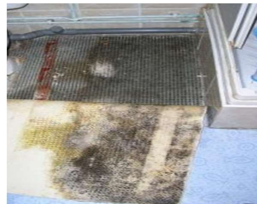
Contamination sous le lino
