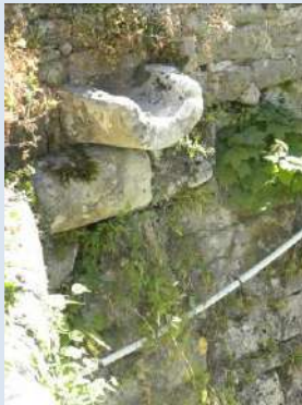
Détail du bandeau semi-circulaire et de la gargouille des douves sèches. Des besoins de réhabilitation sont à noter.
