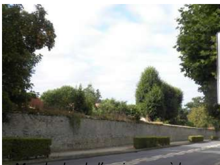
Mur de clos de l'ancien parc à la française des 17 ème et 18 ème siècles le long de l'avenue d'Orléans
