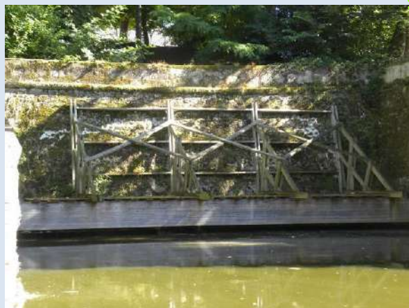
Les douves et les murs de soutènement qui les dominent nécessitent un entretien incessant : besoins de consolidation (ci-dessus), besoins de dévitalisation de la végétation buissonnante qui tend à s'y développer et qui les détruirait à terme (à droite).
