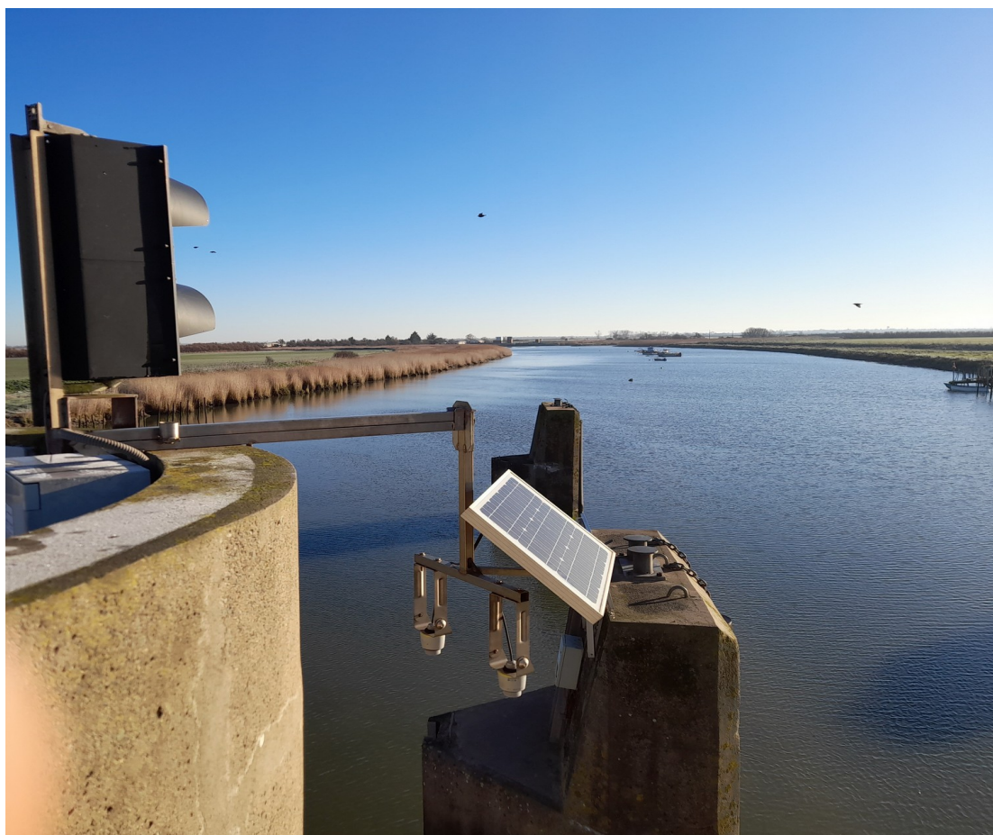
Figure 12: Nouvel équipement installé au marégraphe de Charron-pont-Brault sur La Sèvre Niortaise
